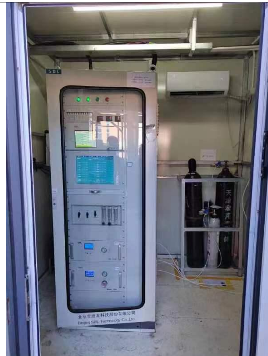
树脂涂装车间保险杠及侧裙喷漆、闪干、最终烘干、调漆、治具清洗排气筒 GR4-1 在线监测设备
