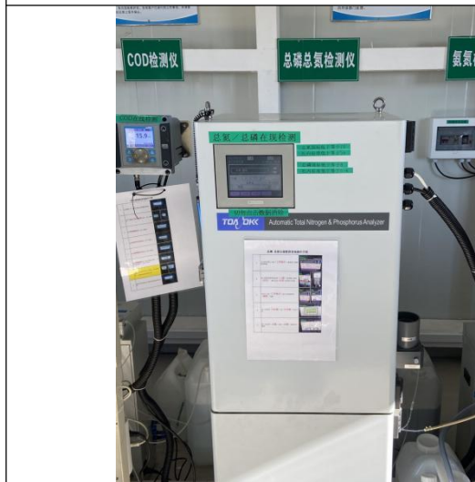
总磷、总氮在线监测设备
