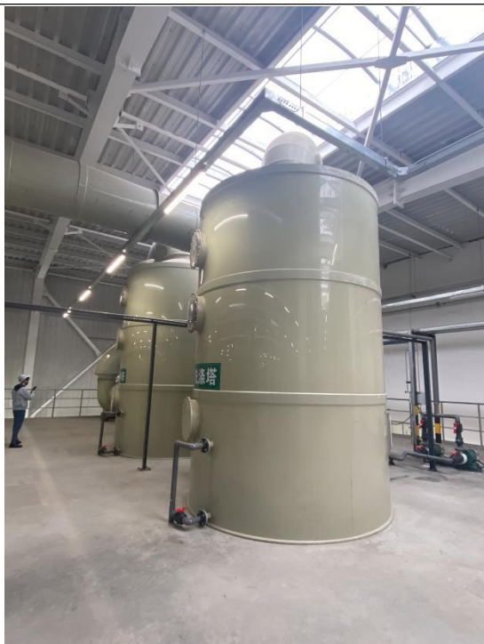
污水处理站生化处理单元异味废气治理设施（碱洗喷淋塔）
