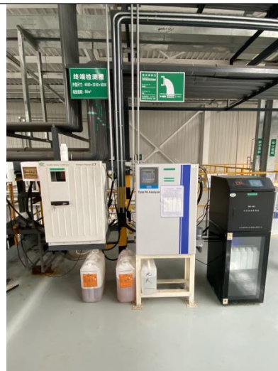
含镍废水排口及其标识牌
