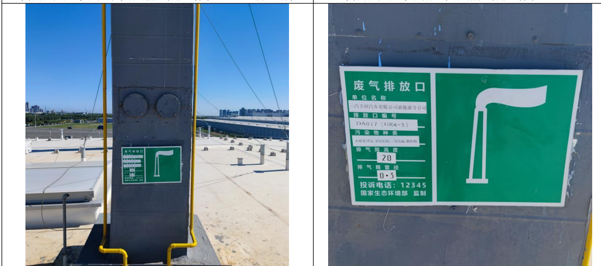
树脂涂装车间烘干炉燃气排气筒 GR4-3 采样口
