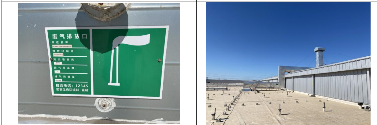
焊装车间小部件焊接排气筒 GW4-5 标识牌
