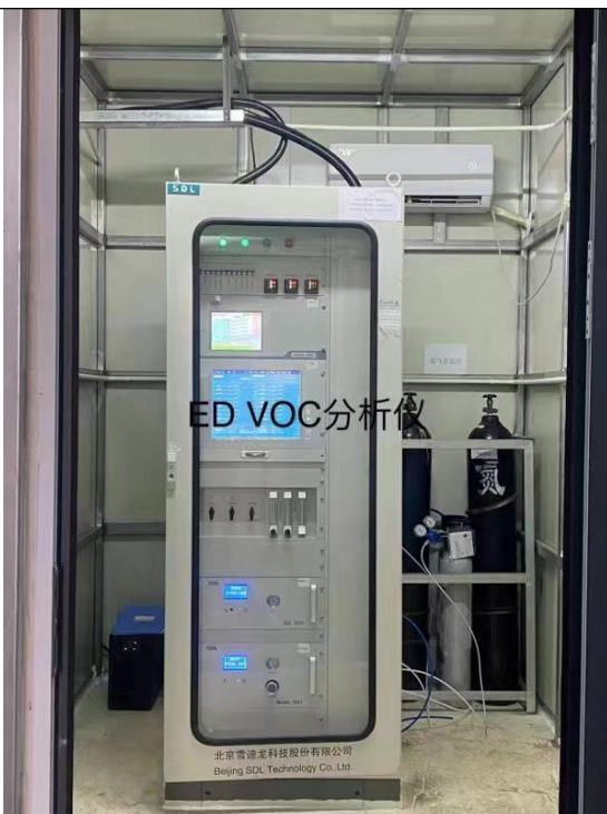
涂装车间电泳涂漆、烘干排气筒 GT4-1 在线监测设备
